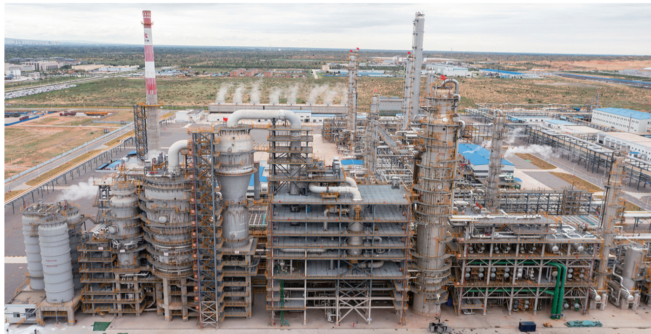
这是2022年7月19日在陕西省榆林市陕西延长中煤榆林能源化工有限公司拍摄的甲醇制烯烃装置(无人机照片)。
