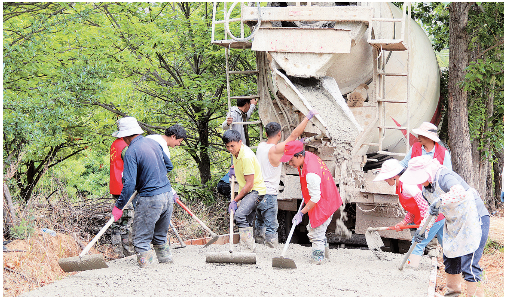
甸头村棚林子易地搬迁点道路施工现场,党员、群众齐心协力抢进度。(摄于5月21日)
