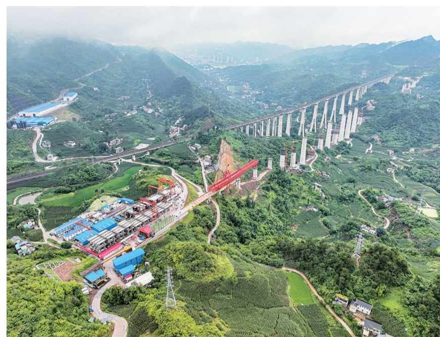
6月26日，渝万高铁新桥双线特大桥梁建设现场，架桥机在架设首孔64m节段拼装梁（无人机照片）。
