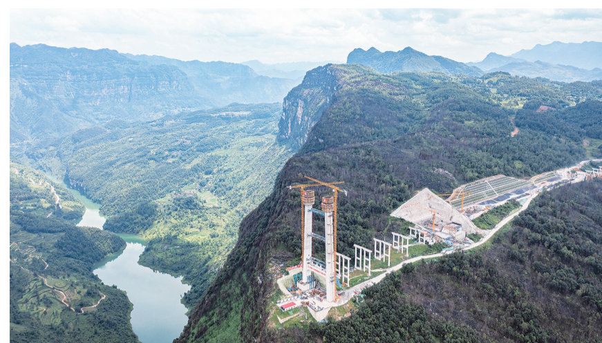
这是7月17日拍摄的建设中的安盛高速天门特大桥（无人机照片）。眼下，由中铁广州局承建的贵州安（安顺）盘（盘州）高速天门特大桥有序推进。天门特大桥是安顺至盘州高速公路的重要控制性工程，大桥全长1553米。【新华社记者 陶亮 摄】
