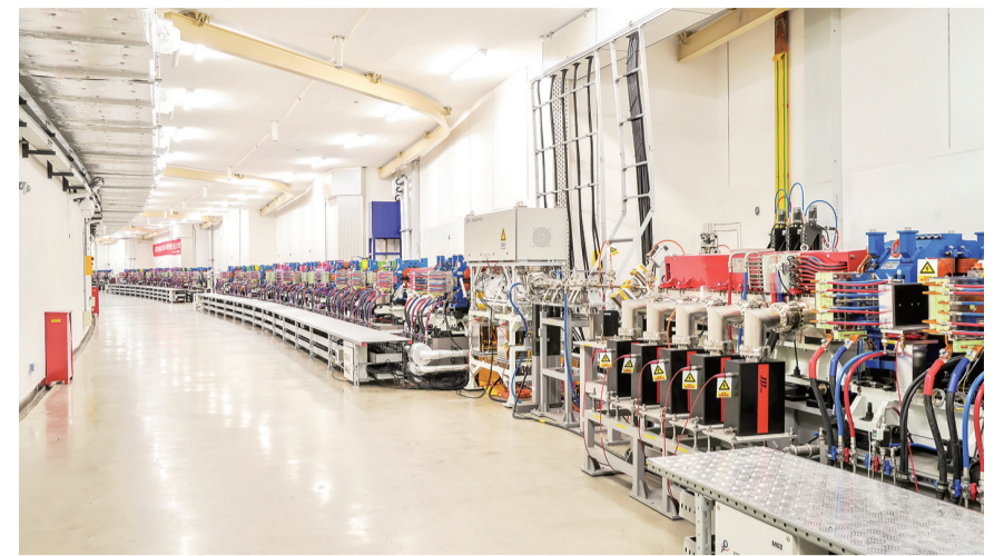
高能同步辐射光源存储环隧道(7月23日摄)。记者8月19日从中国科学院高能物理研究所获悉，国家重大科技基础设施——高能同步辐射光源(HEPS)存储环日前成功实现束流存储，束流流强超过10毫安。存储环是HEPS的核心组成部分，用于存储高能高品质电子束，并产生同步辐射光。HEPS存储环束流轨道周长约1360.4米，圈内面积超过20个足球场，于今年7月1日完成全部设备研制和安装。
