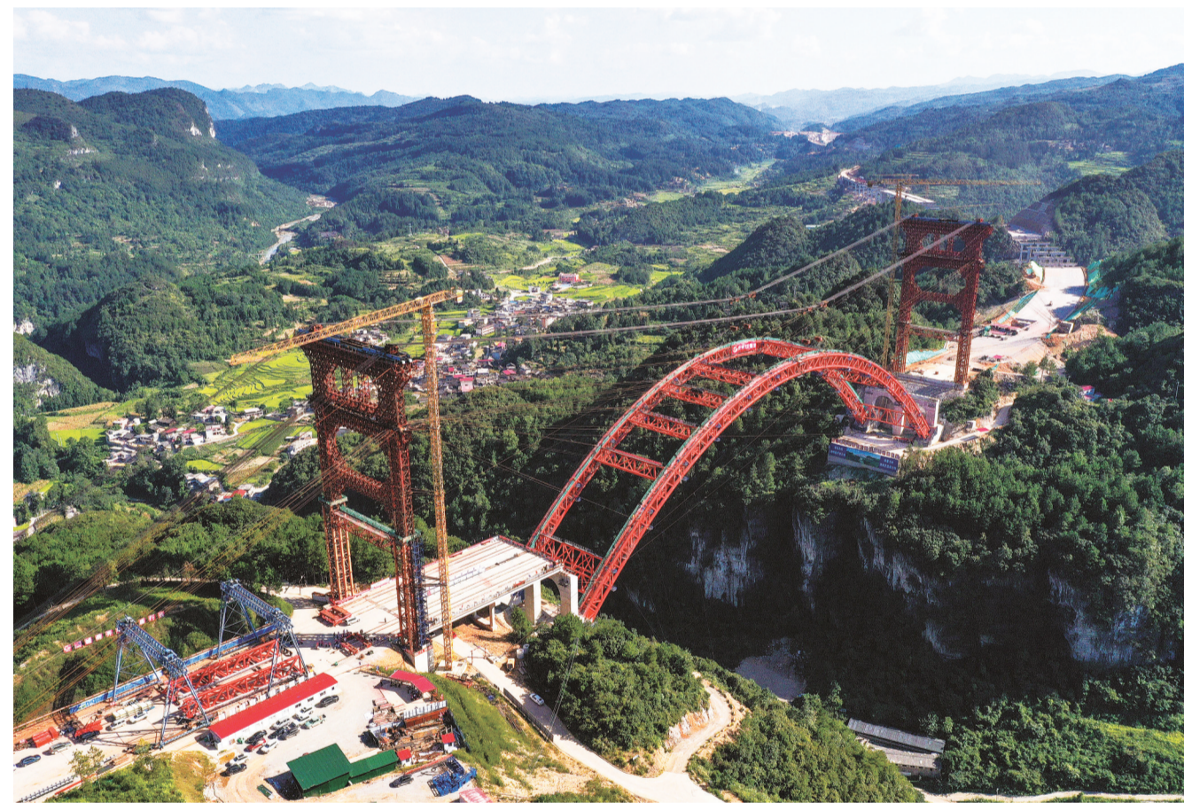
这是8月21日拍摄的贵阳至平塘高速公路马场河特大桥施工现场(无人机照片)。
