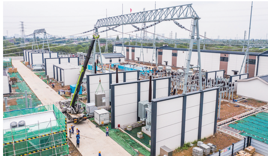
9月3日，空中俯瞰500千伏长兴变电站建设施工现场（无人照片）。位于浙江省湖州市长兴县画溪街道的长兴500千伏输电工程是浙江省重点建设项目，总投资14.38亿元，将建成浙北地区重要的清洁能源消纳和源网荷储互动应用枢纽变电站。这也是长兴县历史上首座500千伏变电站，变电容量200万千瓦，年供电量可达70亿千瓦时。在2025年1月建成投运后可满足浙北地区快速增长的用电需求，补强电网主网薄弱环节，提升区域电网容载比，同时促进绿色低碳转型。【新华社记者 徐昱 摄】
