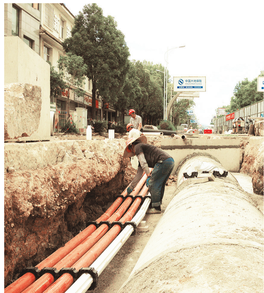
祥云县城市更新改造防排水工程管网入地施工现场。(摄于9月8日) 近年来,祥云县不断推进城市更新改造项目,进一步改善县城人居环境、提升市容市貌、增强县城公共服务水平和综合竞争力,推进以人为核心的新型城镇化建设。 [通讯员 李树华 摄]
