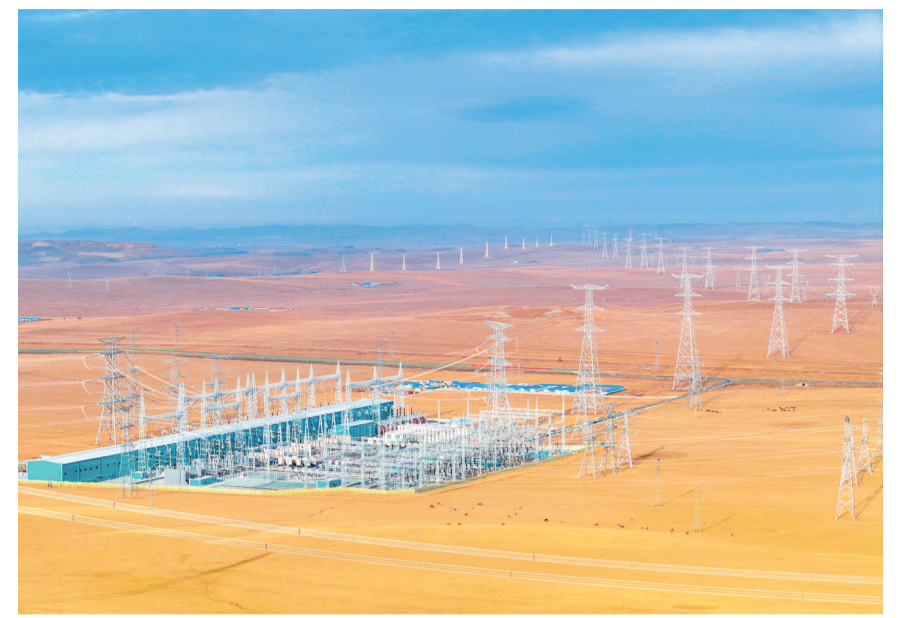
10月31日拍摄的张北—胜利1000千伏特高压交流工程胜利变电站(无人值守站)。当日,张北—胜利1000千伏特高压交流工程顺利投运。该工程起于河北省张家口张北变电站,止于内蒙古自治区锡林浩特市胜利变电站,是国家“十四五”电力发展规划重点项目,每年可向京、津、冀、鲁、苏等地输送电量约700亿千瓦时,将有力促进沿线各地风电、光伏等能源外送能力。【新华社发(王正摄)】
