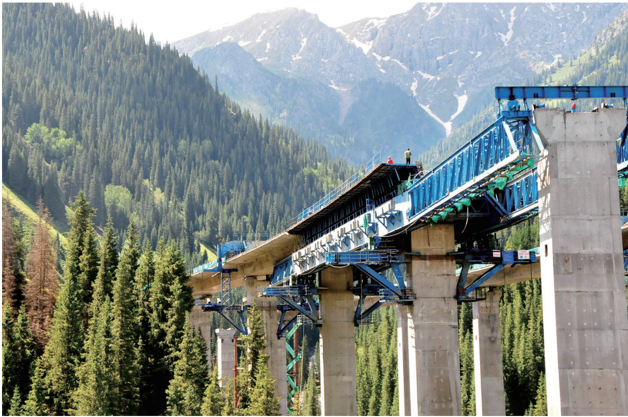
正在紧张施工的赛果高速公路穿越崇山峻岭(7月18日摄)。近日,正在紧张建设中的赛果高速公路(赛里木湖至果子沟)标志性工程赛里木湖隧道贯通,高达215.5米的果子沟斜拉桥主体塔架已浇筑完成,工程逐步转入桥面施工阶段。赛果高速公路全长约56公里,是连霍高速公路新疆段重点控制工程。 [新华社记者 李紫恒 摄]
