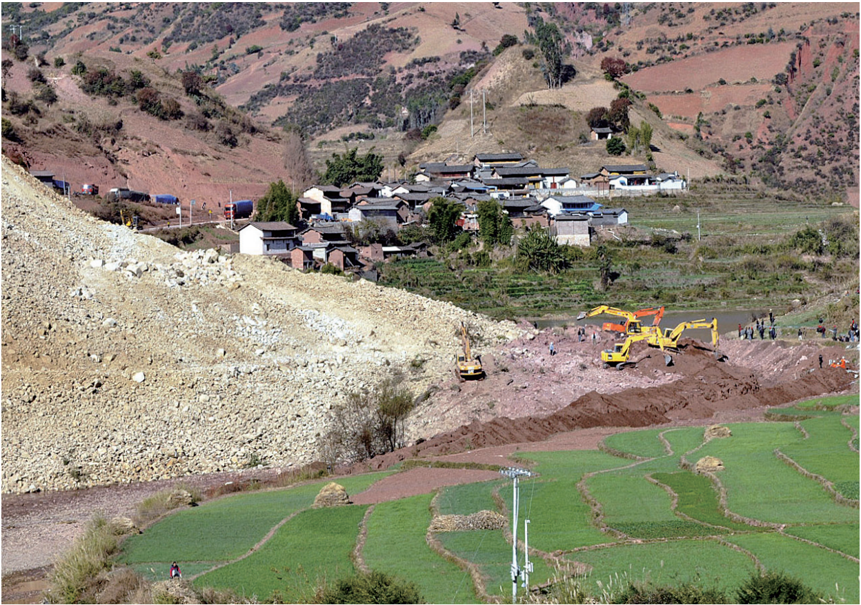
12月18日,几台挖掘机在山体滑坡现场疏浚河道。 12月17日19时50分,云南省云龙县诺邓镇境内发生山体滑坡,造成黄金公路和泚江河道阻断,形成了堰塞湖。据测算,滑坡土石方约135.8万立方米,截至18日12时15分,堵塞的泚江河堰塞湖已达48.6万立方米。目前,抢险工作正有序开展。 〔新华社 发〕
