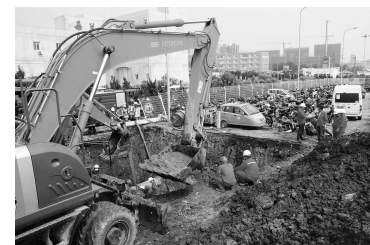
7月1日,工人在中石油新大一线输油管道泄漏事故现场处置管道泄漏点。
