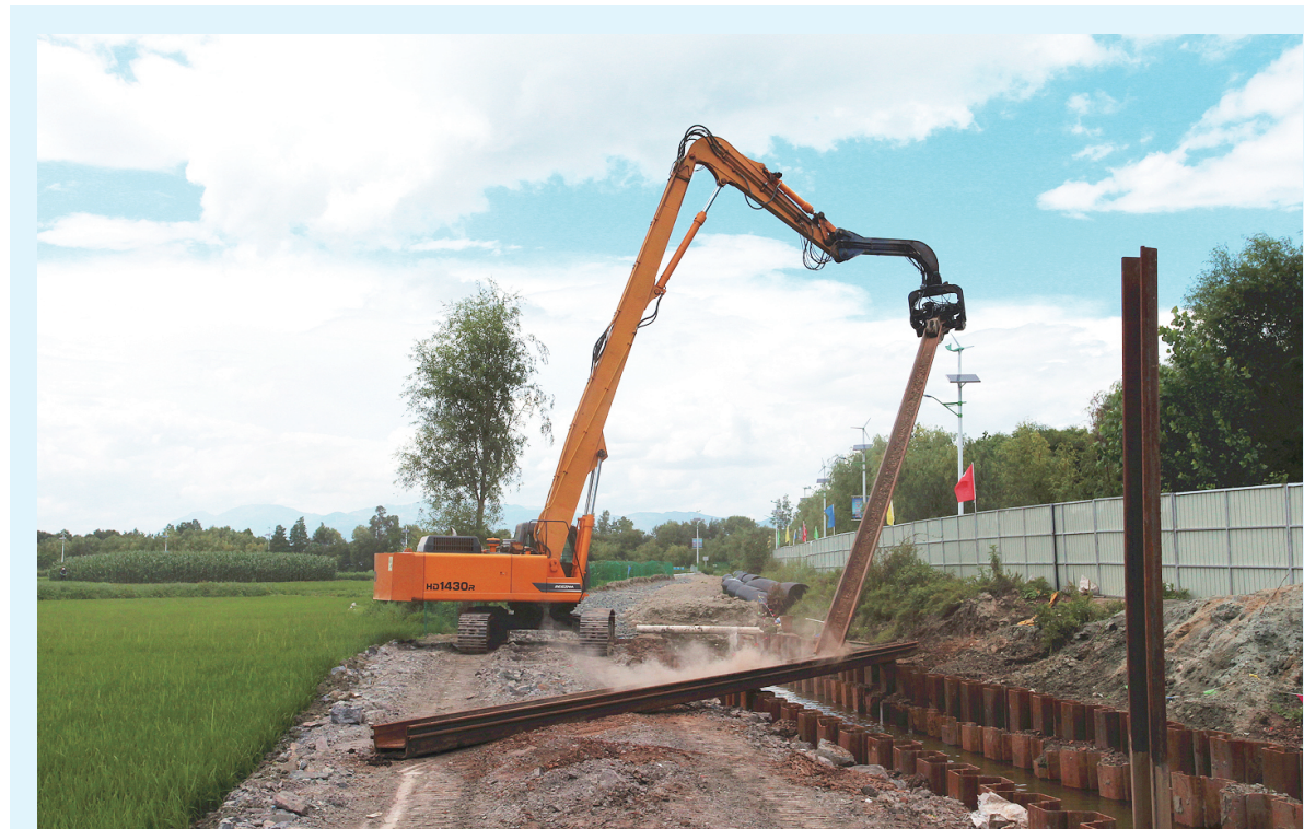
6月15日下午,大理市喜洲镇仁邑村截污工程标段,深圳市鸿博建设工程有限公司工人正在操作机械截污板桩。全长234.2公里,直径800至1200毫米,分6个标段,11个泵站,计划总投资34.9亿元的大理市洱海环湖截污工程PPP项目自去年10月开工建设以来,正按计划有序推进,将在2018年底完工。届时,将对洱海形成一道污水“防火墙”。 [记者 涂序波 摄]
