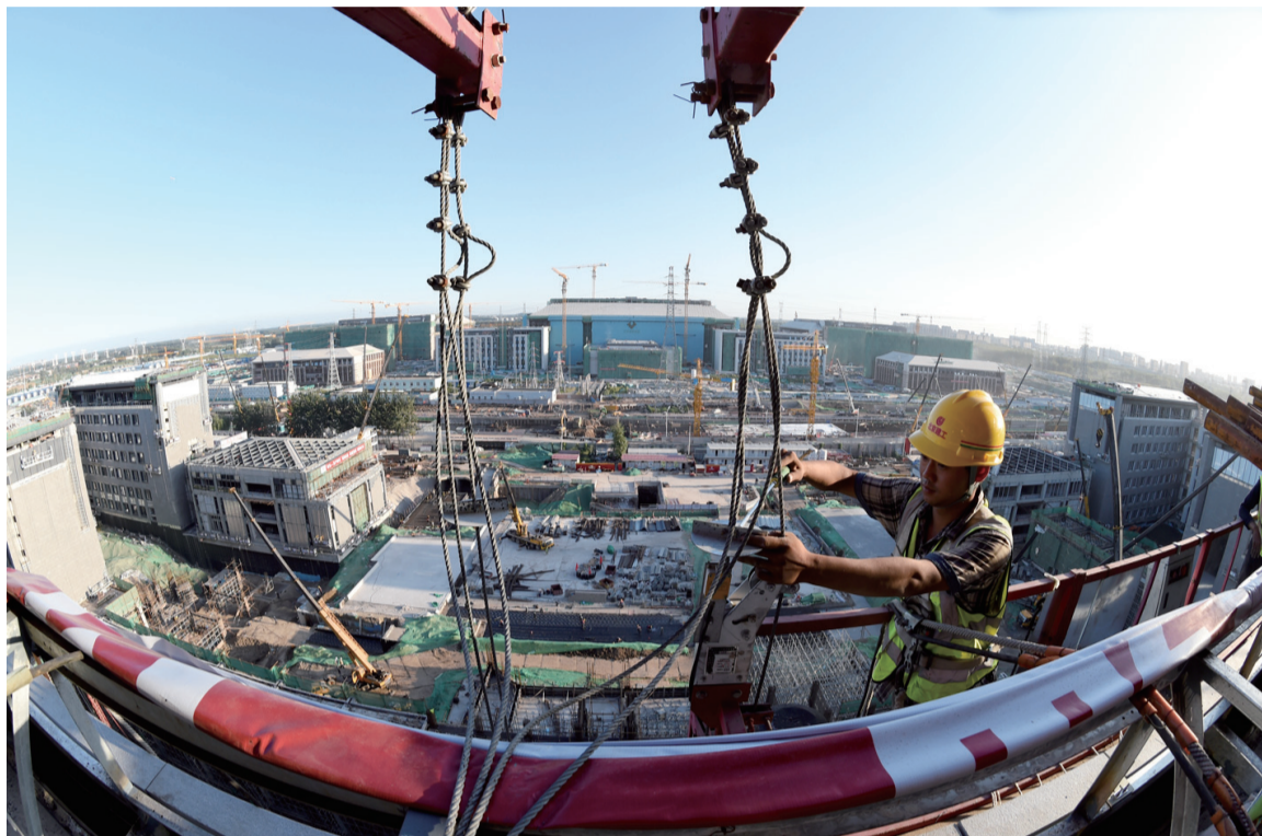
工人在北京建工集团城市副中心A2工程工地施工(9月11日报)。
