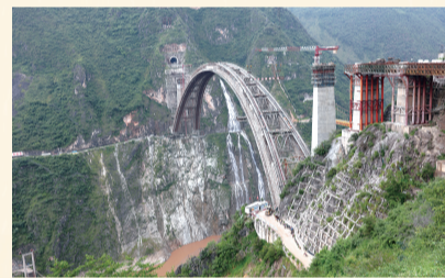
连接大理与保山两地的澜沧江特大桥是大瑞铁路上的重大项目,建设初期建行就积极介入,多渠道为项目提供金融服务。
